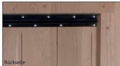
Rückseite Stahlprofil & Entlastungsrillen
